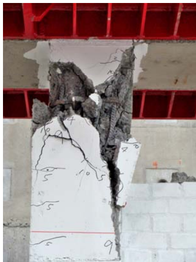
側位移比1.75%，核心混凝土嚴重損壞
