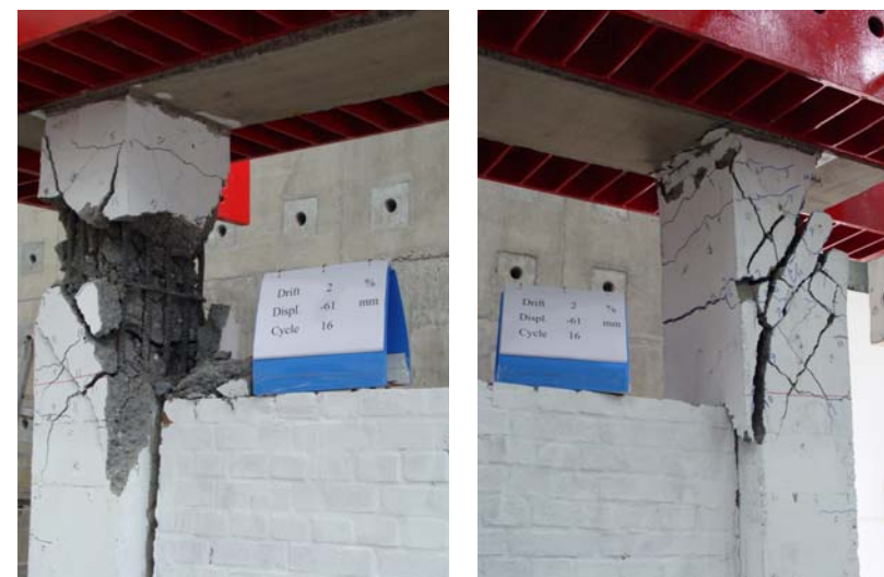
側位移比2%，在短柱區域中央之核心混凝土嚴重破損
